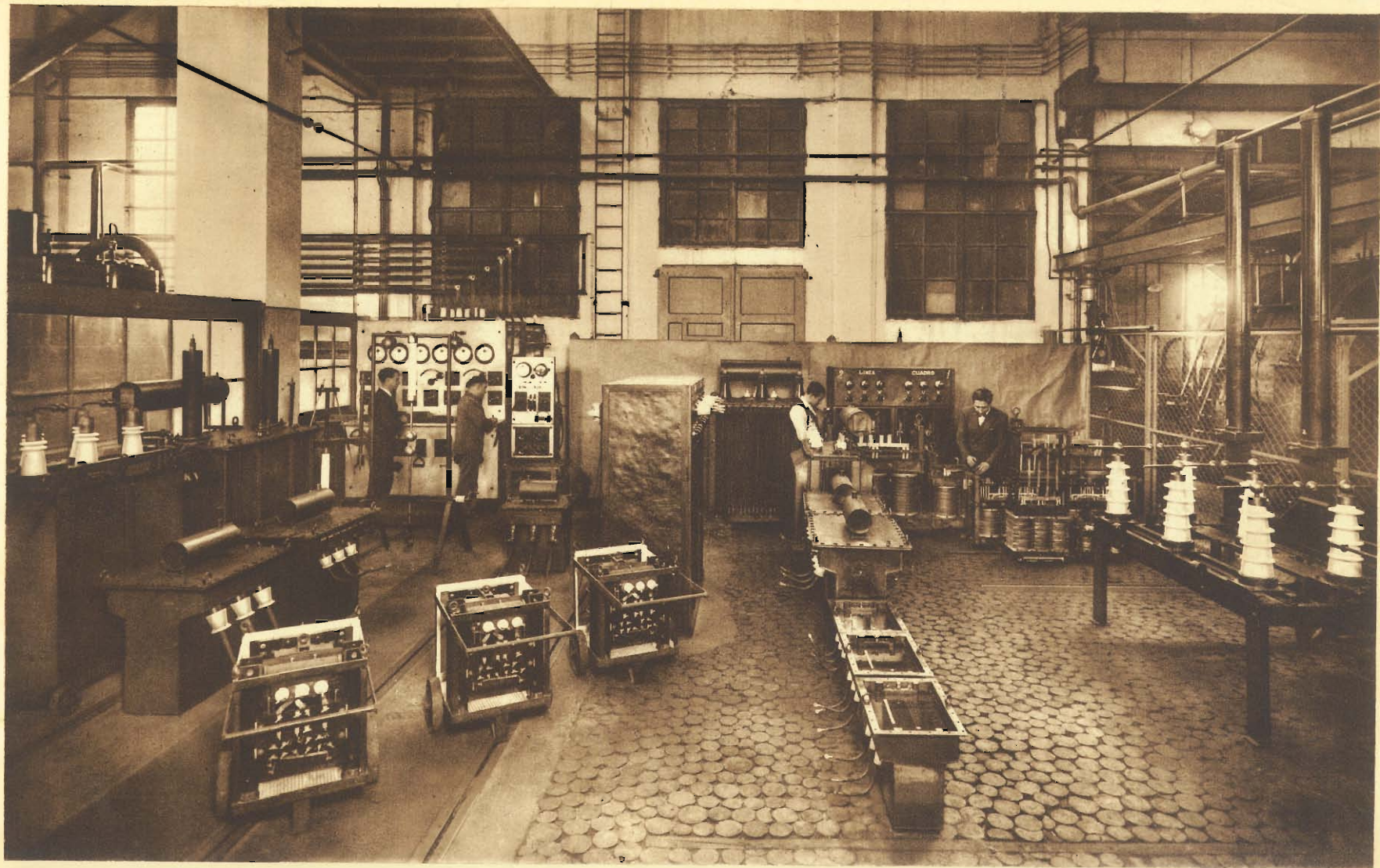
S ECCION especial para la prueba de transformadores que dispone, además de los otros aparatos, de un transformador y de condensadores para la prueba de ondas escarpadas.
